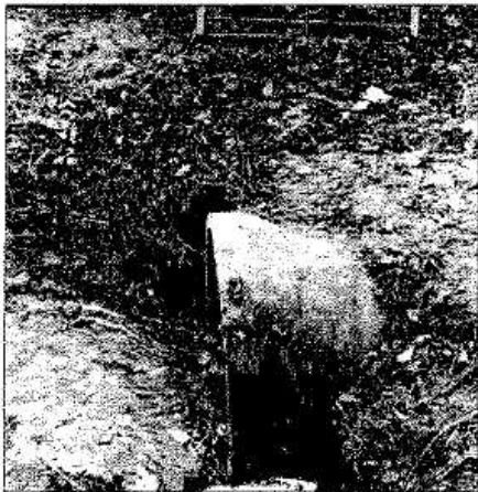
La qualité de l'entretien de la grille du drain d'évacuation de l'Emolière est mise en cause par les riverains.
